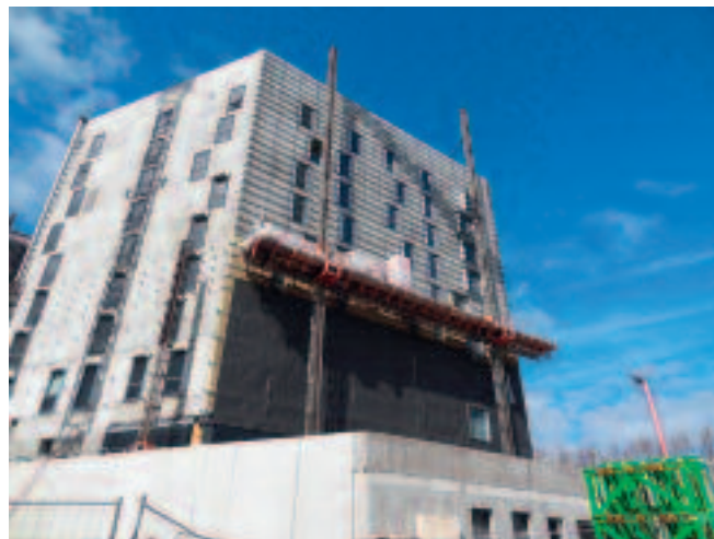
Figure 33. Plate-forme sur mât (© SFECE).
