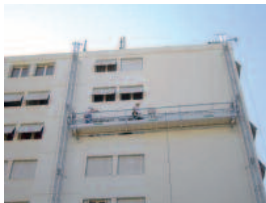
Figure 10. Plate-forme suspendue sur mâts (© SFECE).
