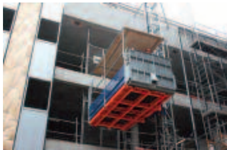
Figure 53. Plate-forme de transport dotée d'un toit de protection et de portes palières de pleine hauteur (© SFECE).
