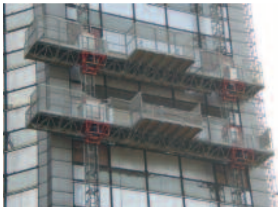
Figure 46. Plates-formes sur mâts double niveau : les deux plates-formes circulent indépendamment l'une de l'autre (© SFECE).
