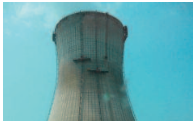
Figure 44. Chantier de rénovation d'une tour aéroréfrigérante (mâts épousant un ouvrage courbe avec correction de l'horizontalité automatique) (© SFECE).
