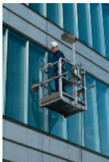
Figure 18. Nacelle en phase d'exploitation (© SFECE).
