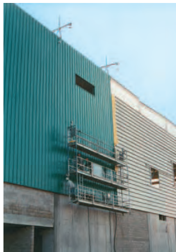
Figure 23. Plate-forme à triple niveau en exploitation (© SFECE).
